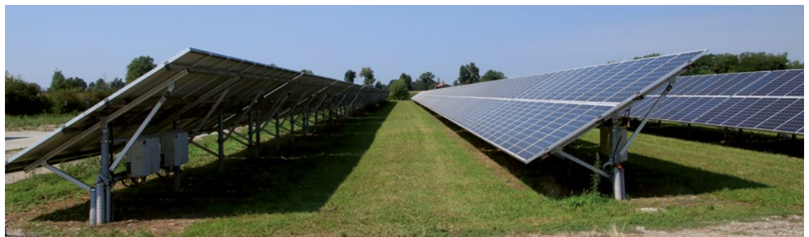
Figura 89 Panel de módulo fotovoltaico en condiciones verticales
